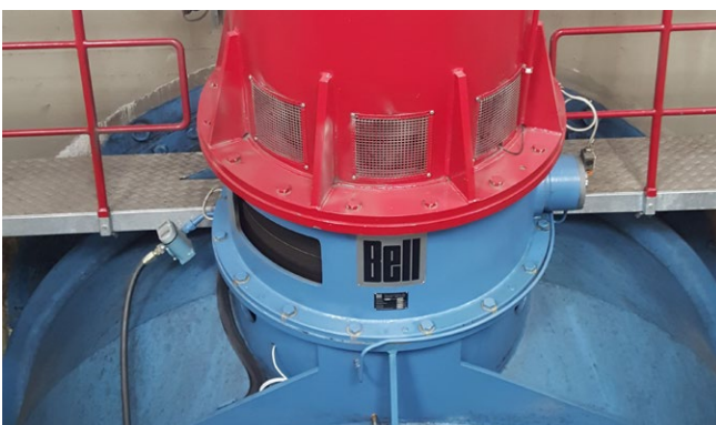
SAK Flusskraftwerk mit Getriebe
